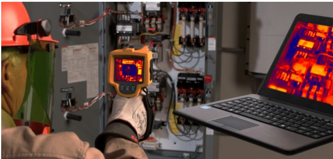
Рисунок 20. Пример проведения тепловизионного контроля электрошкафа
